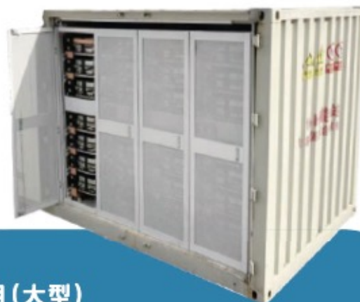
1MWh 10フィートコンテナ
